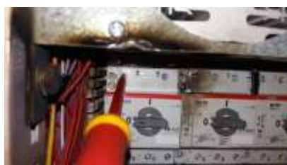
Zona en la que se produjo el cortocircuito. Situación simulada SIN TENSIÓN y con destornillador aislado.
