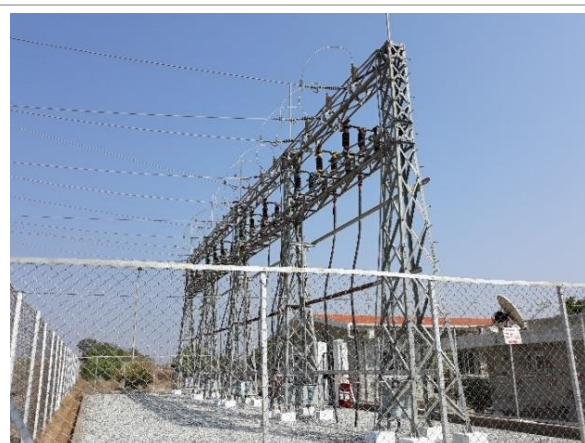
Detalle del pórtico de entrada de la subestación al que llegan cuatro circuitos procedentes del parque eólico (dos líneas de doble circuito).
